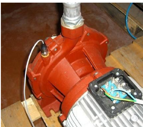
Obrázek 5: Příklad nasávacího otvoru na výtlačku čerpadla s připevněným snímačem
